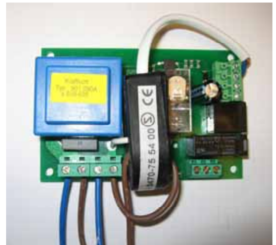
Inkoppling av 1 styck UV-ljusram. Matning till ramen genom strömmätaren.
