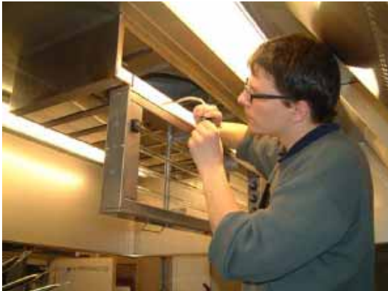
Kabelns anslutning till UV-ramens stickkontakt.
