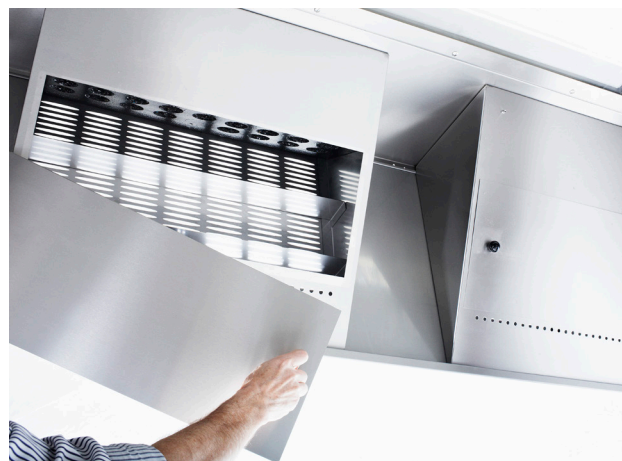
På insidan av kökskåpa Evac-T, bakom tilluftsdonet, finns tilluftshuset. Inspektionsluckan öppnas endast vid finjustering av luftflödet eller invändig rengöring
